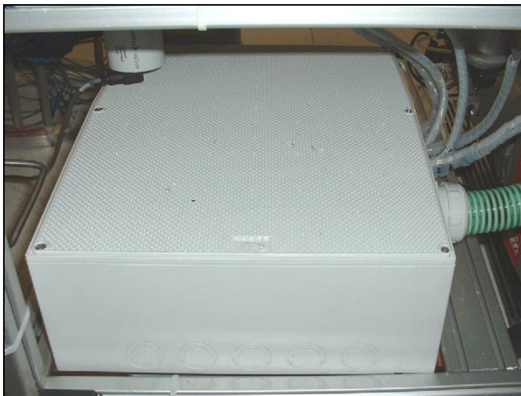
Figura 3-7: Particolare della scatola che contiene tutti i fili delle fasce riscaldanti.
