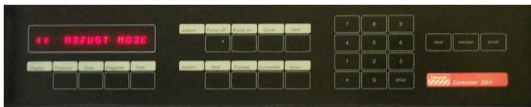
Figura 20. Pannello del controllore a microprocessore
