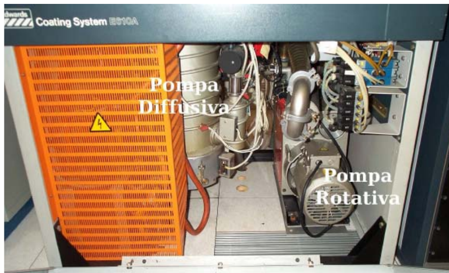
Figura 19. Foto del sistema di pompaggio
